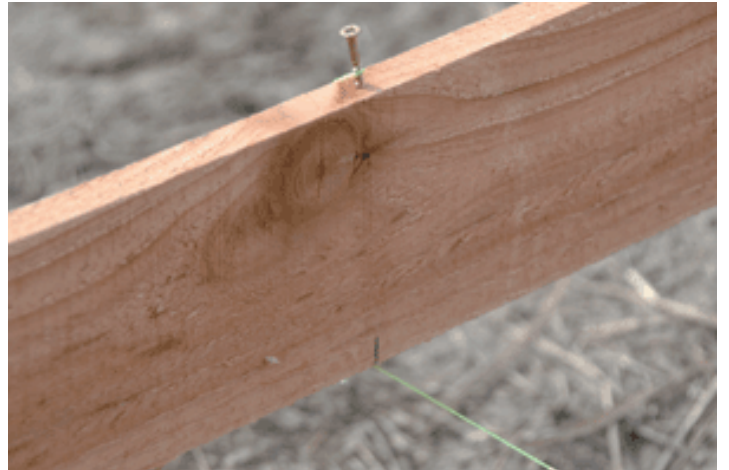
貫板にビスを打ち糸を張る (写真は貫板の下から水糸を通した方法)
